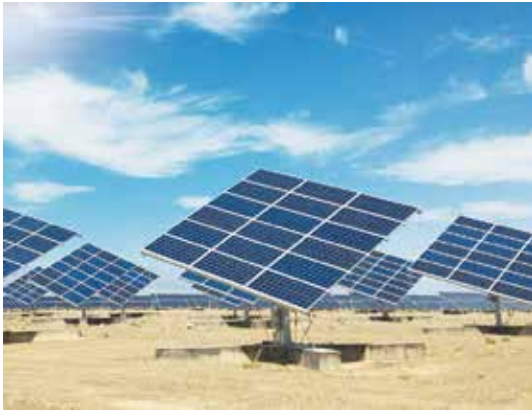
China Xinjiang TBEA Power Plant 中國新疆柳樹泉特變電站
